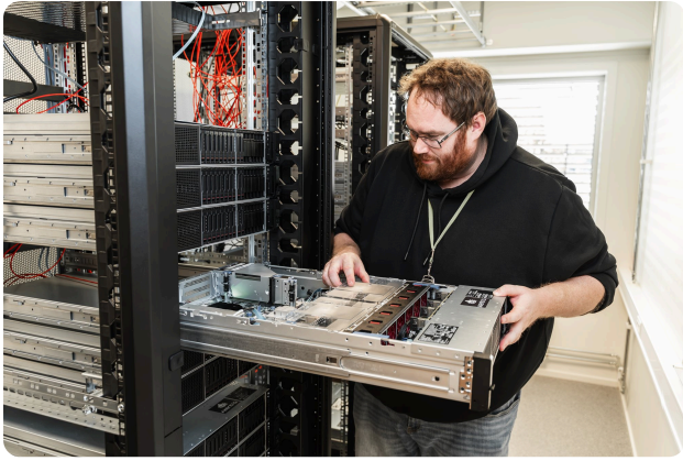
Pakke ut, racke, sette i cluster: Håvard brukte omtrent én arbeidsdag på de ni serverne. Foto: Anders Bakken Photography
